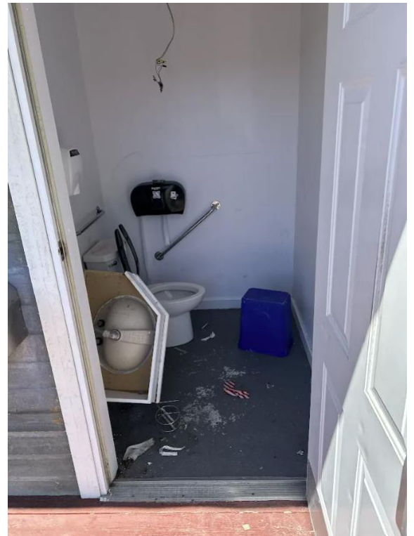
Bloc sanitaire du parc Pierre-et-Maurice-Gagné vandalisé.
