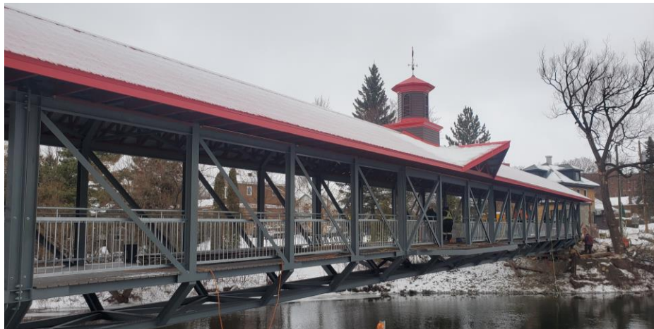
La nouvelle passerelle J.-Napoléon-Pérusse sera ouverte temporairement pour la période des fêtes. © Ville d'Amqui
